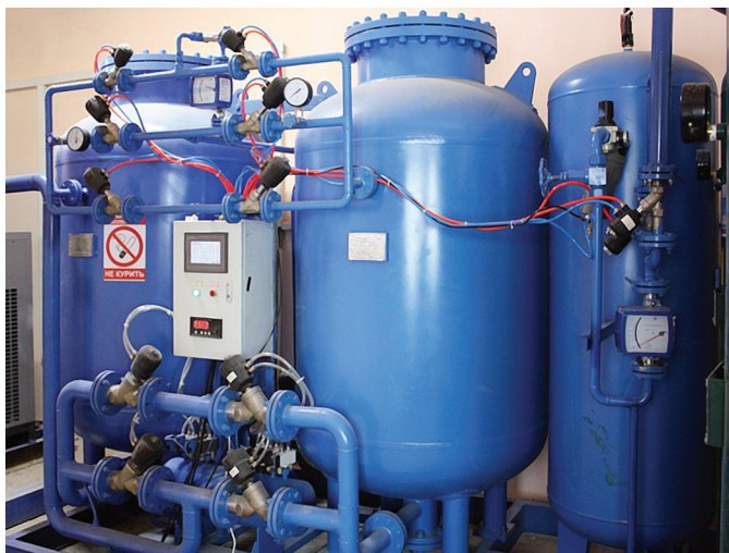
Фото 3 - Фрагмент кислородной станции, установленной за счет ТОО «СП «Казгермунай»
