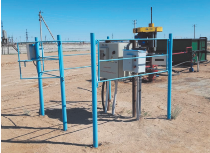
Рисунок 3 – Скважина №80, оснащенная интеллектуальной станцией управления со SCADA – пакетом
