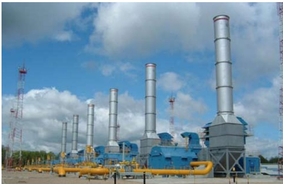
Вид типовой компрессорной станции.
