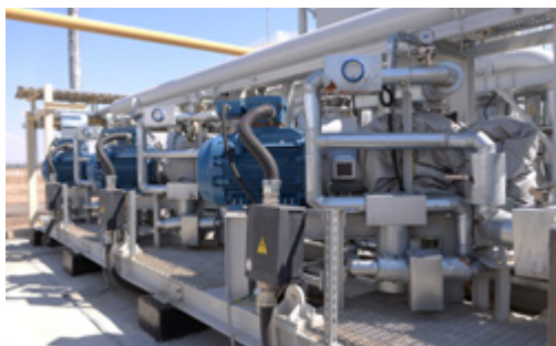
Установка рекуперации паров на нефтеперекачивающей станции им. Н. Шманова
